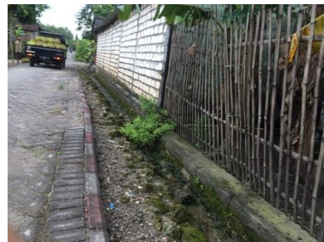
Gambar 10. Kondisi Drainase di Jalan Lingkungan
