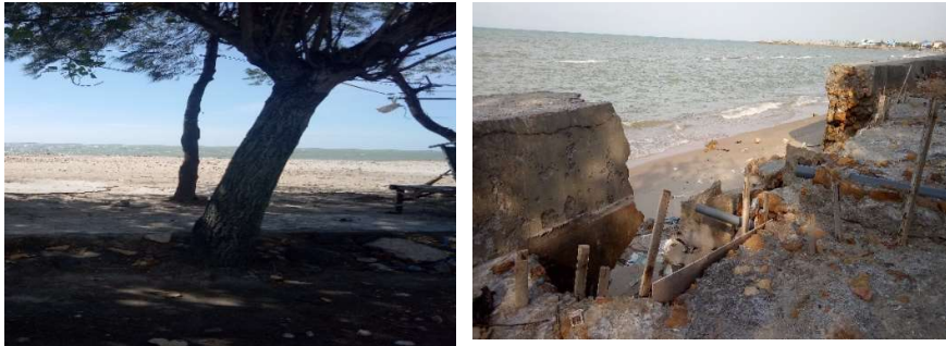
Gambar 7. Rusaknya Tanggul Akibat Gelombang Ekstrim
