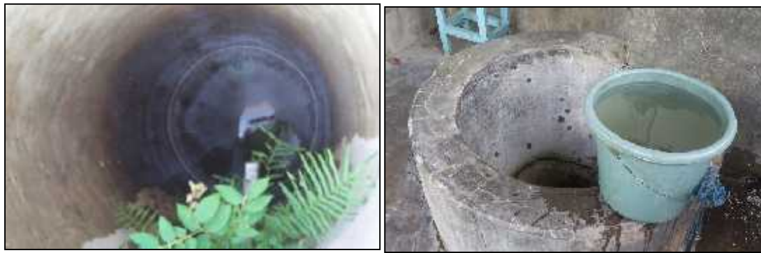
Gambar 4. Kondisi Sumur di Desa Pejarakan
