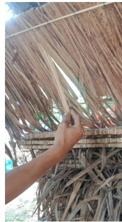
Gambar 6. Daun Tebu Kering Material Atap Rumah Tinggal Kampung Adat Keputihan. (Sumber: Dokumentasi Penelitian Nia Emilda, dkk., 2024)
